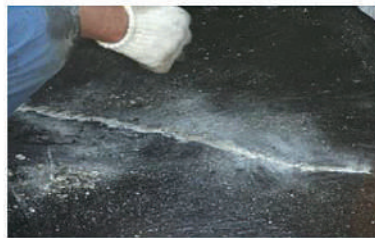
防水層撤去下地面への補修 (ひび割れ補修、剥落・欠損補修など)
